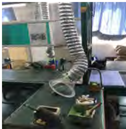
焊锡工位废气收集装置
