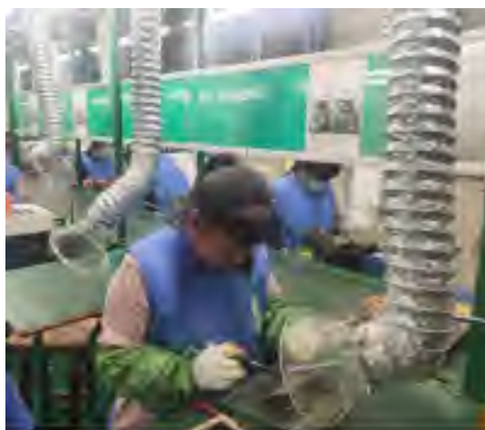
焊锡工位废气收集装置
