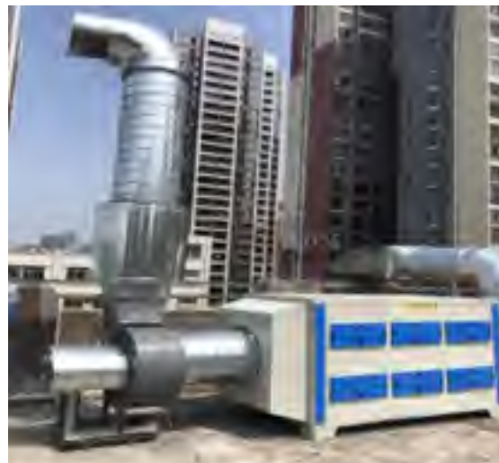
废气处理装置
