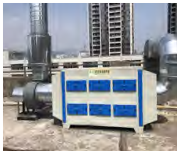
废气处理装置
